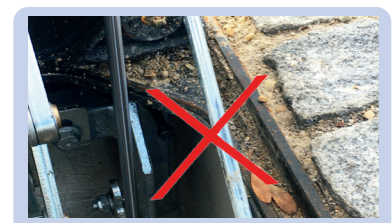
Abb. 10: SO NICHT: Sand auf Dichtung und Auflagefläche
