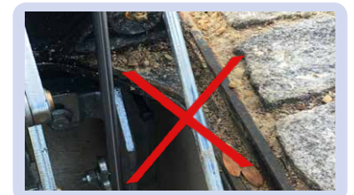
Abb. E: SO NICHT: Sand auf Dichtung + Auflagefläche
