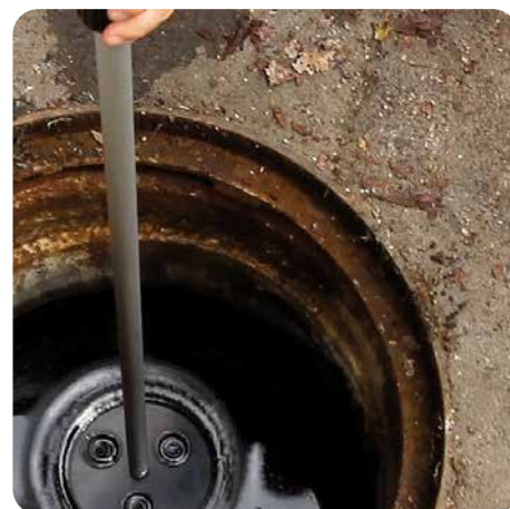
Sichtkontrolle der Abscheideroberfläche bei einem SeparatorBLUE
